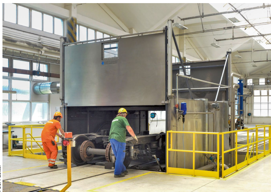
Die neue Drehgestell-Reinigungsanlage mit zwei Hubtüren für das Reinigen und Spülen mit Passivieren von bis zu 5100 \times 3035 \times 1550 \text{ mm} großen Komponenten wurde auf einer Fläche von nur 50 \text{ m}^2 realisiert.
